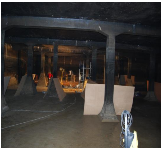
Rys. 5. Część układu technologicznego uzdatniania wody 2
